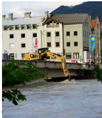
Die Bausubstanz der Brücke ist mittlerweile so schlecht, dass im Hochwasserfall kein Bagger auf der Brücke stehen dürfte.
