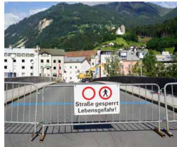
Die Steinbrücke muss dringend erneuert werden. Die Bausubstanz der 94 Jahre alten Brücke würde einem Hochwasser nicht mehr standhalten.
