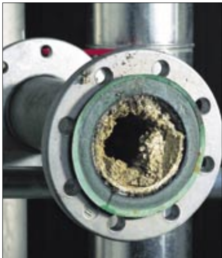
Hart wie Beton: Abfall- bzw. Fettablagerungen im Kanal verursachen hohe Kosten.
