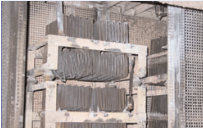
Die zerstörten Widerstände (Brandherd).
